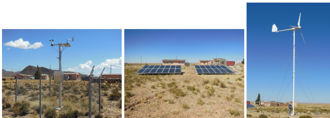
Figura 13: Instrumentos instalados en Patacamaya: estación meteorológica, celdas solares y generador eólico
